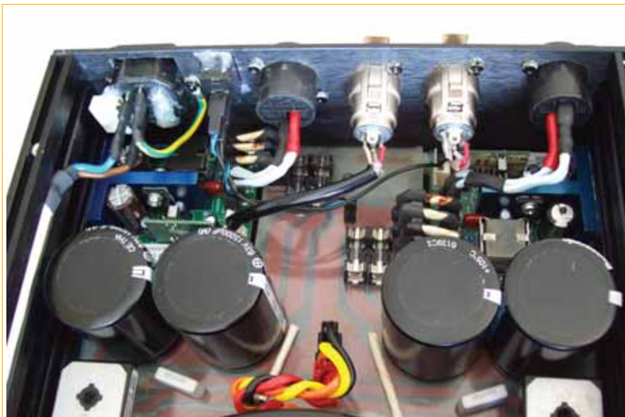
Figura 12: Vista dei cablaggi.
